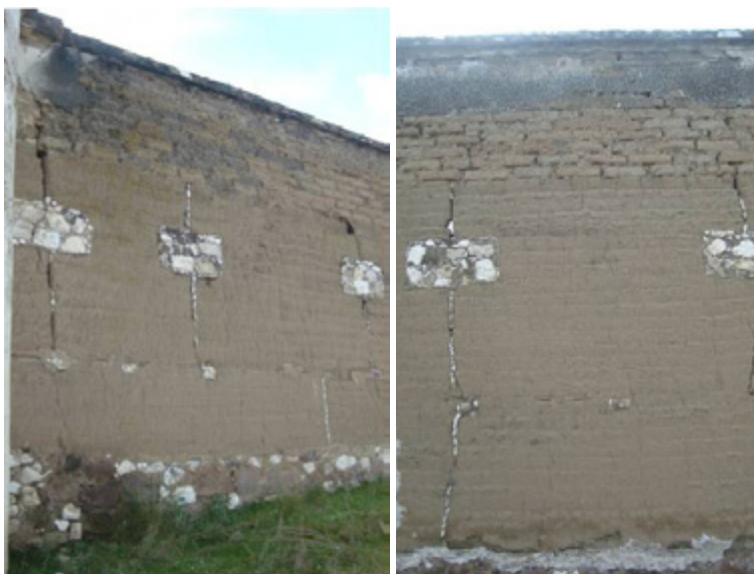
Figura 11. Estado de conservación de muros de tapia con cerramiento de adobe. Imágenes del autor
