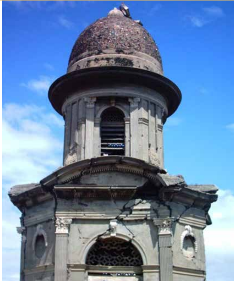
Figura 4. Daño en la torre.
