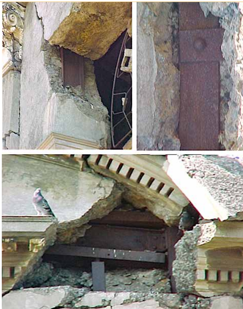
Figura 3. Imágenes que ilustran el estado de conservación de la estructura metálica.
