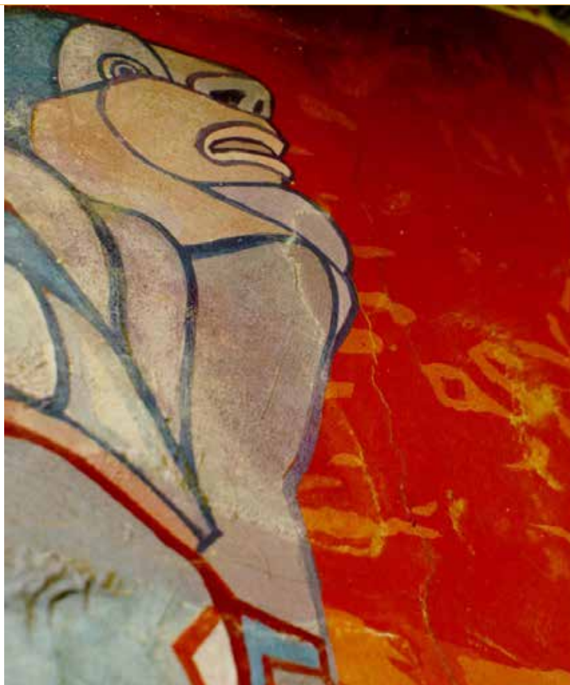
Figura 7. Imagen que ilustra la presencia de sales sobre la superficie del mural.
